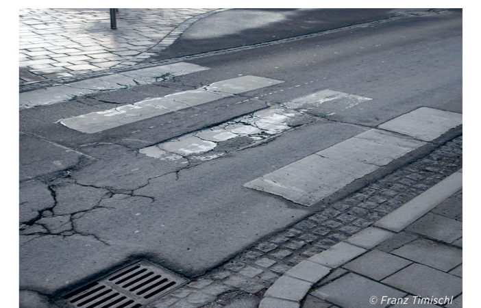
- Sanierungsbedürftiger Zebrastreifen in der Santnergasse
